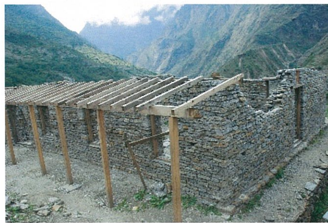
建設中の教員宿舎も被害を受けた
