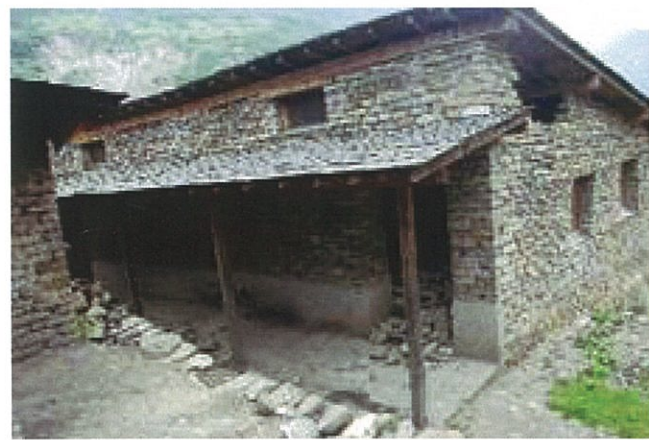
便所棟の被害の様子
